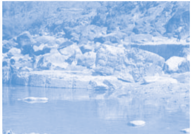
Imagen 2: Abatimiento y colapso de puente tras fuerte aguacero (carretera Butwal-Nepalganj, Nepal Occidental). Fuente: Deoja et al., 1991.
