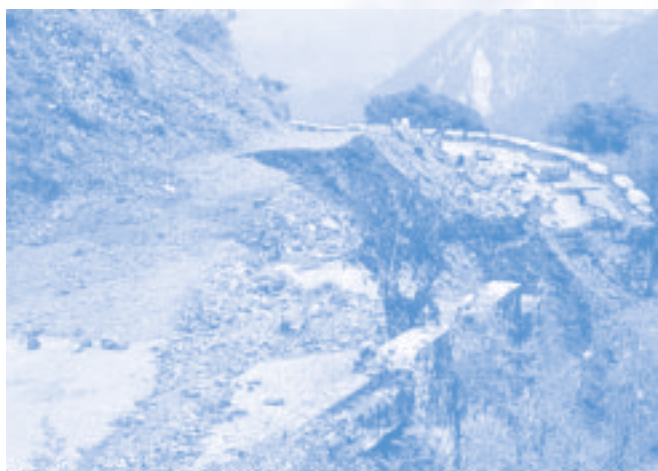
Imagen 3: Colapso de ladera debido a terremoto y fuertes lloviznas (carretera Dharan-Dhankuta, Nepal). Fuente: Deoja et al., 1991.
