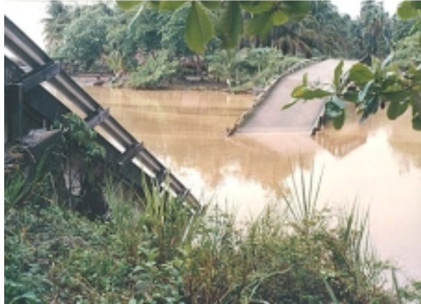
Foto 1: Terremoto en Limón, Costa Rica 1991
