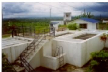
Foto 19. Planta de tratamiento de Quinindé Fuente MIDUVI
