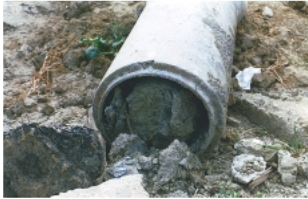
Foto 20. Tubería de alcantarillado obstruída Fuente: Macías / Portoviejo, Ecuador
