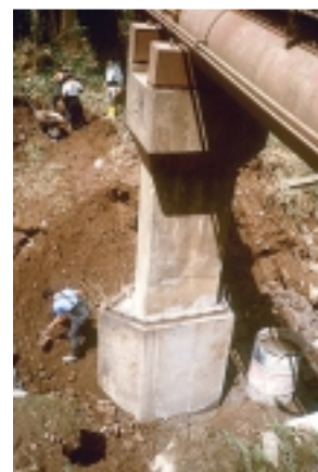
Foto 13. Construcción de cimiento y columna en paso de río Fuente Arturo Rodríguez / Costa Rica
