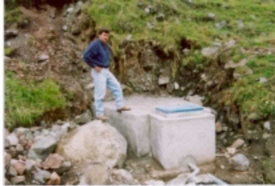
Fotos 12. captación vulnerable a la caída de rocas Fuente MIDUVI
