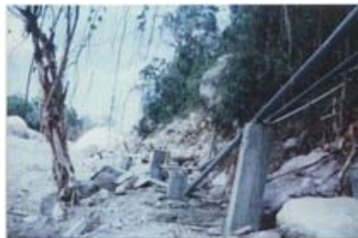
Foto No. 3 Tubería destruida
