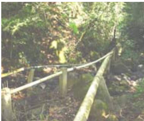
Foto No.12 Estructura débil de los anclajes
