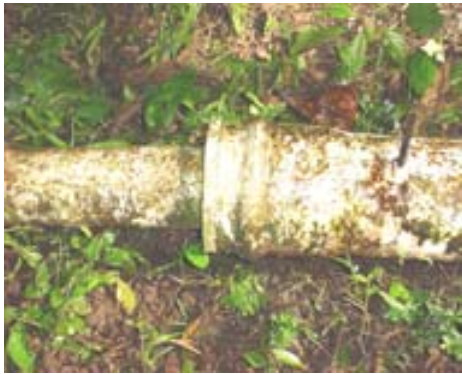
Foto No. 10 cambios drásticos en la tubería
