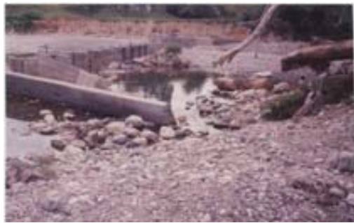
Foto No. 2 Asolvamiento en presa de derivación
