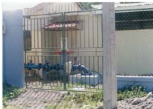
Foto No. 6 destrucción en Estaciones elevadoras
