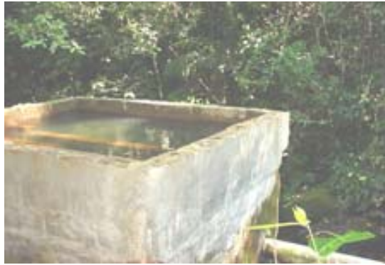
Foto No.9 Contaminación en los desarenadores
