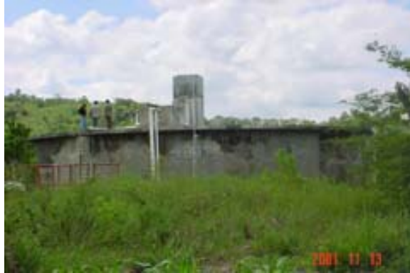
Foto No.2 tanque de distribución
