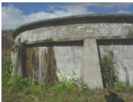
Foto No.3 Tanque de Distribución
