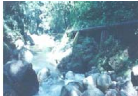
Foto No. 2 Anclajes de línea de conducción
