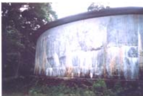
Foto No.3 Tanque de distribución
