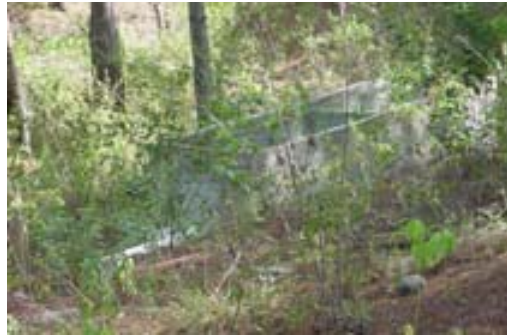
Foto No.2 desarenador dañado
