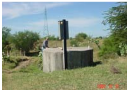
Foto No. 4 Protección de los Pozos campo Santa Martha
