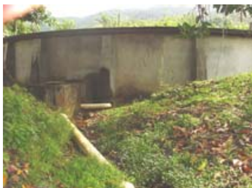
Foto No.2 Tanque de almacenamiento
