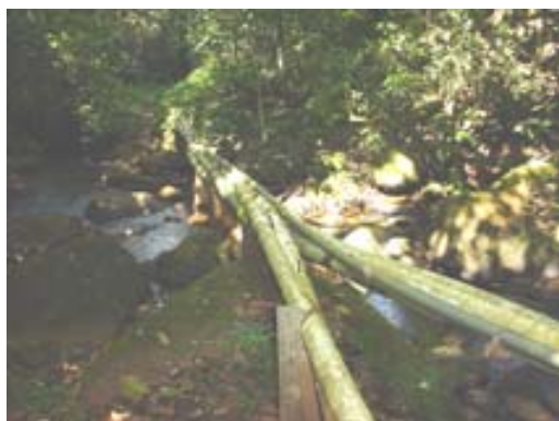
Foto No.7 Tubería PVC expuesta
