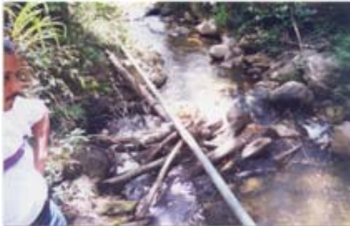
Foto No.1 Tubería de PVC expuesta
