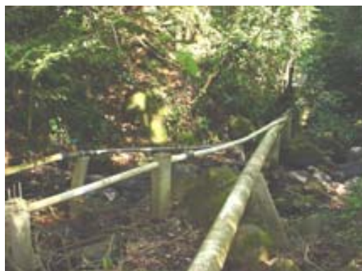
Foto No.8 Tubería PVC expuesta
