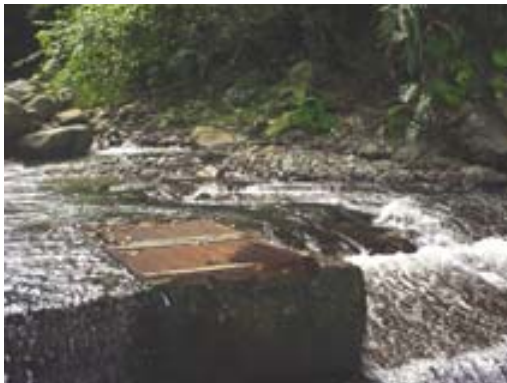
Foto No.3 Destrucción de desarenador
