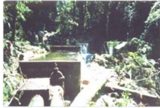
Foto No.4 Destrucción de tubería
