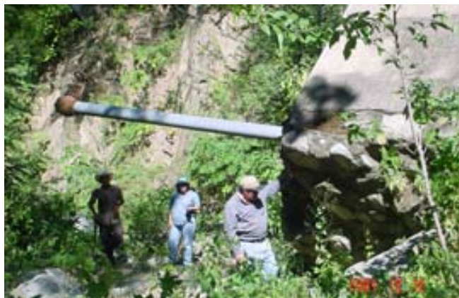
Foto No. 1 Desarenador destruido, presa Guanacaure
