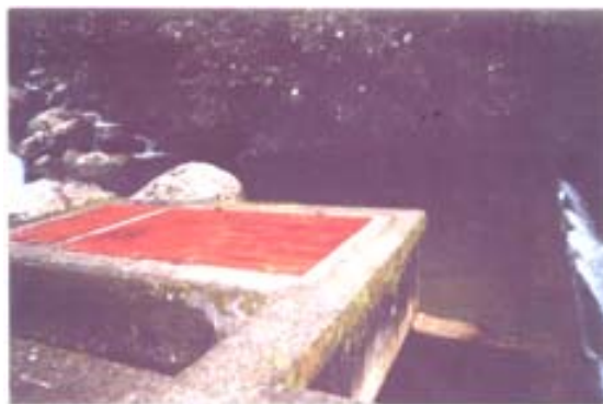
Foto No. 2 Captación destruida
