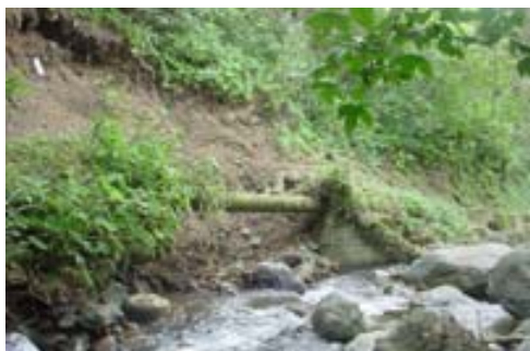
Foto No. 1 Anclajes muy débiles
