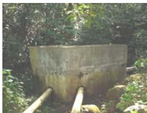
Foto No.5 Desarenador del sistema
