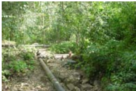
Foto No. 2 Tubería expuestas
