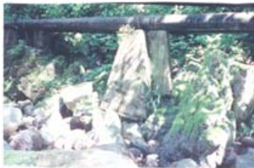
Foto No. 1 Anclajes de línea de conducción
