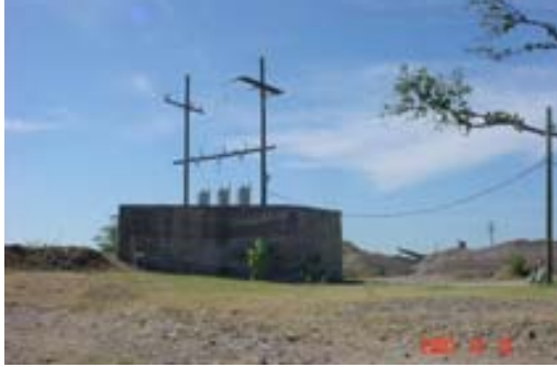
Foto No. 5 Protección de los postes de Energía
