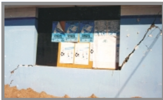
FIGURA 1 DAÑOS EN ESTABLECIMIENTO DE SALUD DEL PRIMER NIVEL DE ATENCIÓN. MOQUEGUA: TERREMOTO DEL SUR DEL PERÚ. 2001
