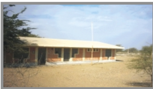
FIGURA 3 ESTABLECIMIENTO DE SALUD UBICADO EN ÁREA INUNDABLE. CHATO CHICO - PIURA. PERÚ. 2005
