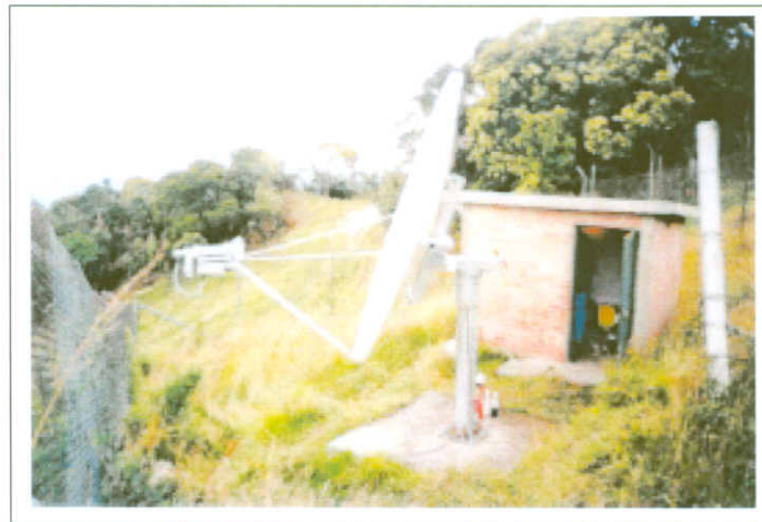
Figura 4. Caseta de la estación del CTBTO ubicada en El Rosal.
